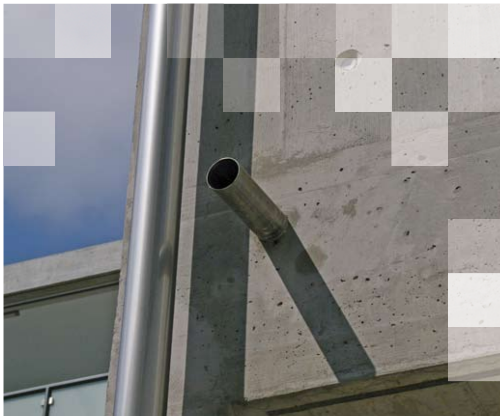
Immeuble à St. Gall: ecoulement de balcon
