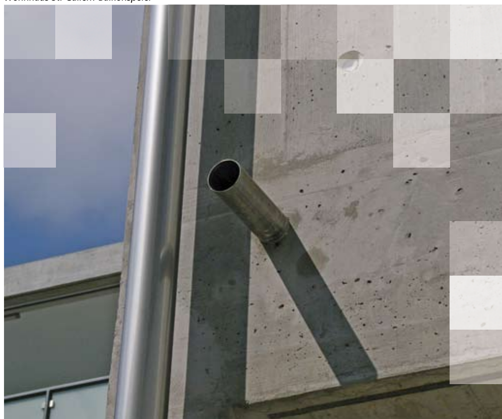
Wohnhaus St. Gallen: Balkonspeier
