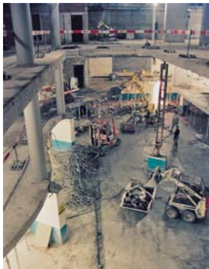
MM Bâle: déconstruction avec élévateur et chargeuse à pneu du type «Bobcat»
