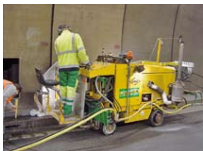
Tunnel du Gotthard: sciages au sol, machine équipée de filtre à particule et aspirateur d'eau et de poussière
