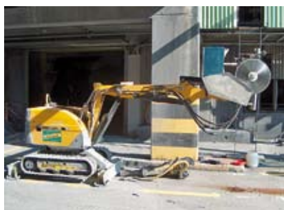
Alcan-Valais: coupe de rails de courant électrique avec une machine de notre propre conception
